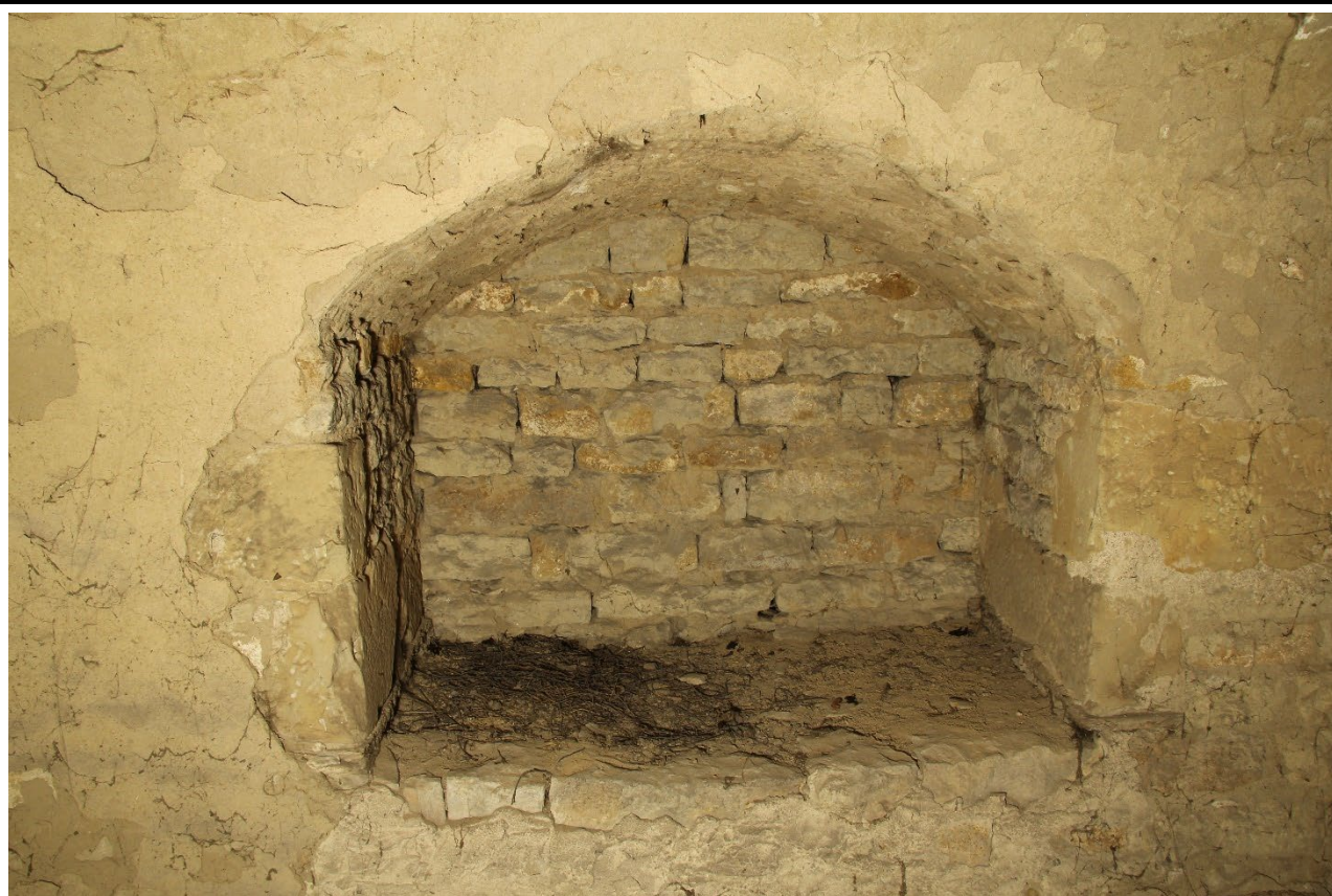
Detail niky severní stěny 1. patra věže v pohledu od jihu. Foto: Jaroslav Skopec, 2018.
