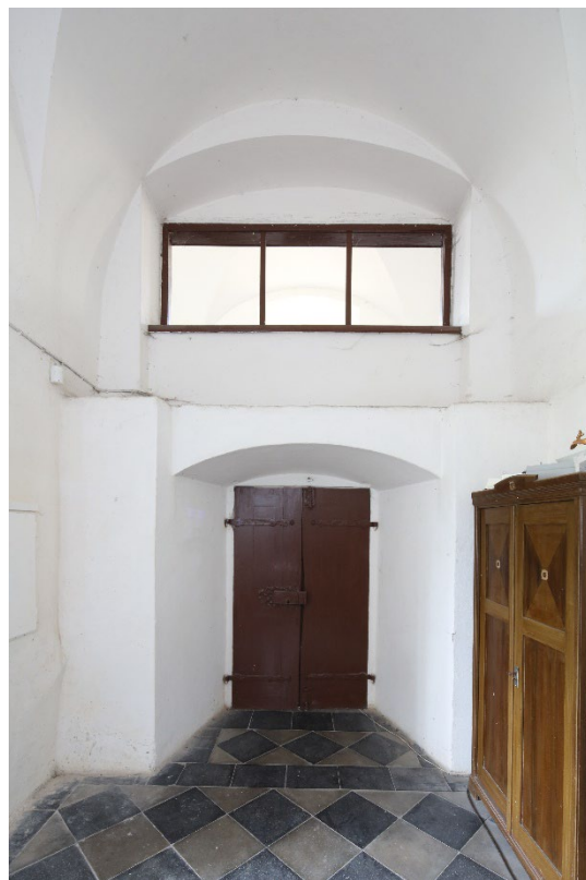
Jižní stěna sakristie v pohledu od severu se vstupem z presbytáře, nad nímž se nachází výrazné odsazení stěny. Foto: Marta Pavlíková, 2018.
